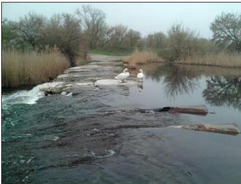
Рис. 3. Пошкодження гребня греблі
